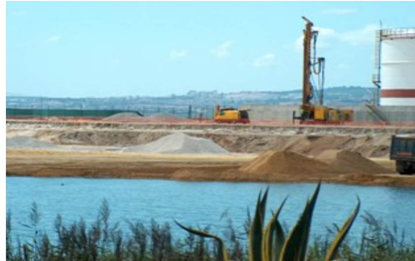
LBC Tanquipour, Portugal – Capacity expansion
