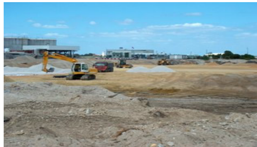
LBC Tanquipour, Portugal – Capacity expansion
